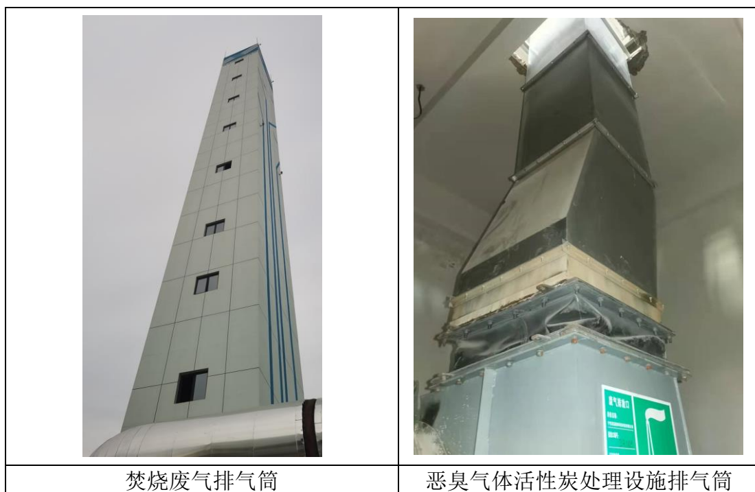
图4.1-2 废气治理措施
