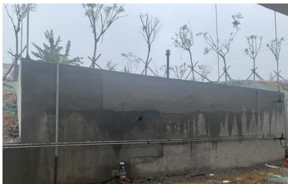
柴油储罐区围堰
